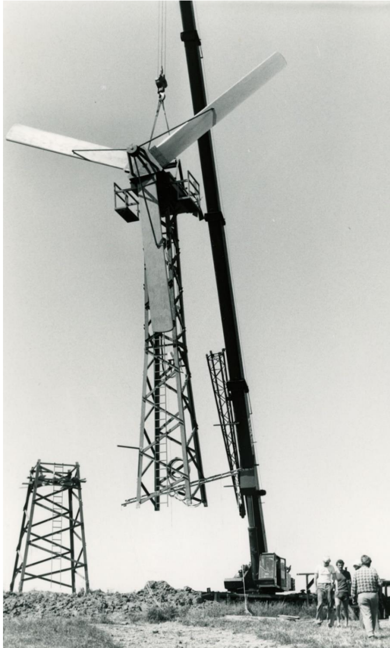
10. Danebod Møllen med nacellen og vinger løftes på plads på nederste del af tårnet. Foto: Bent Kentov. MUSEUM SØNDERJYLLANDS MEDIARKIV.
